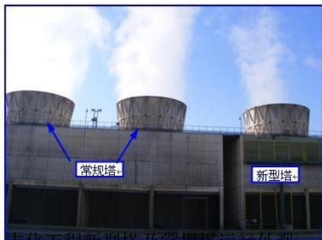
图1 吉化工程新型塔及常规塔运行外观
