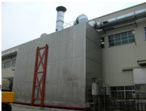
图 1 生物过滤除臭装置（4000m 3 /h，用于污水处理恶臭气体治理）
